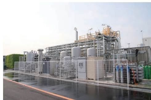
実証設備全景（提供：大阪ガス）
