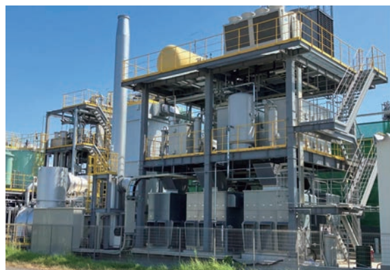
実証プラント
